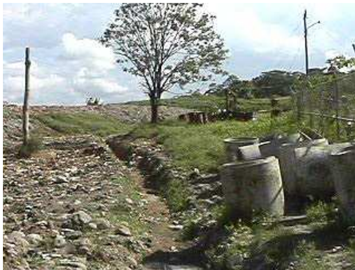
Fotografía N° 2 Canal periférico para aguas pluviales Lindero Oeste (colindancia con calle pública) Fecha: 19 de Marzo de 2003
