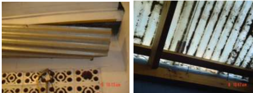
FOTOS No. 6 Condiciones del techo del Mercado Municipal
