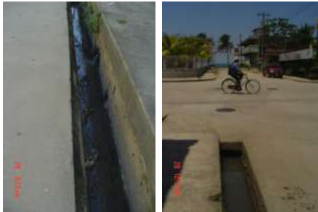
FOTOS No. 1 Disposición de Aguas Pluviales del Municipio de Tela
