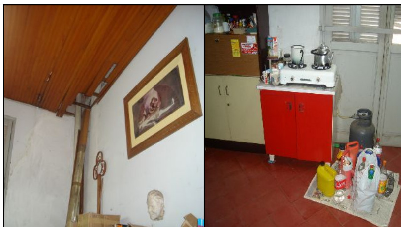
En el atelier de restauración hay goteras y roturas del cielo raso. En el mismo sitio se encuentra la cocina con garrafa de gas, enseres y depósito de alimentos y limpiezas.
