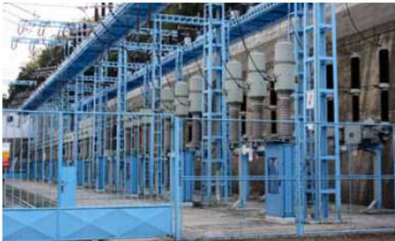
Subestación eléctrica en planta de energía hidroeléctrica Štechovice (© Regina Charyparová)
